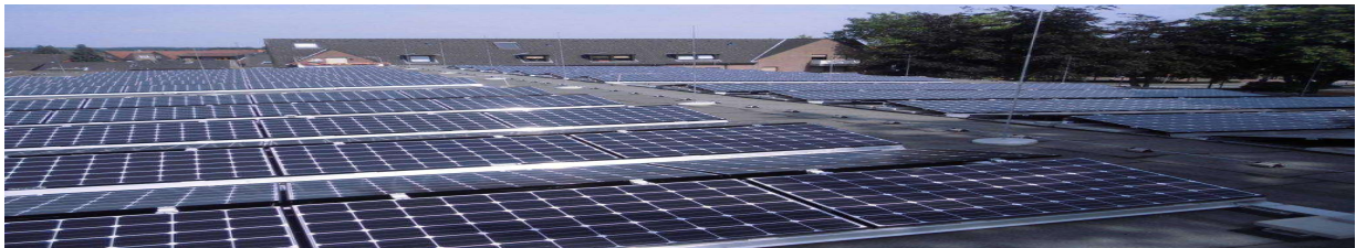
PV Anlage auf dem Dach der Turnhalle 1, Leistung 56 KW, Schulzentrum Straelen . Deckt damit 42 % des Strombedarfs der Sekundarschule.
